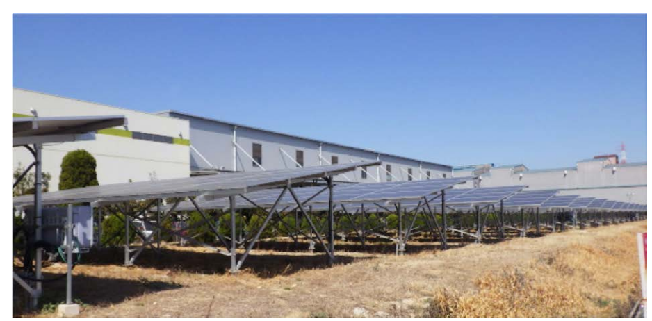
※水島工場に設置した、太陽光発電設備（2022年1月稼働）
