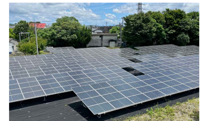
八代工場敷地内に設置した太陽光発電設備
